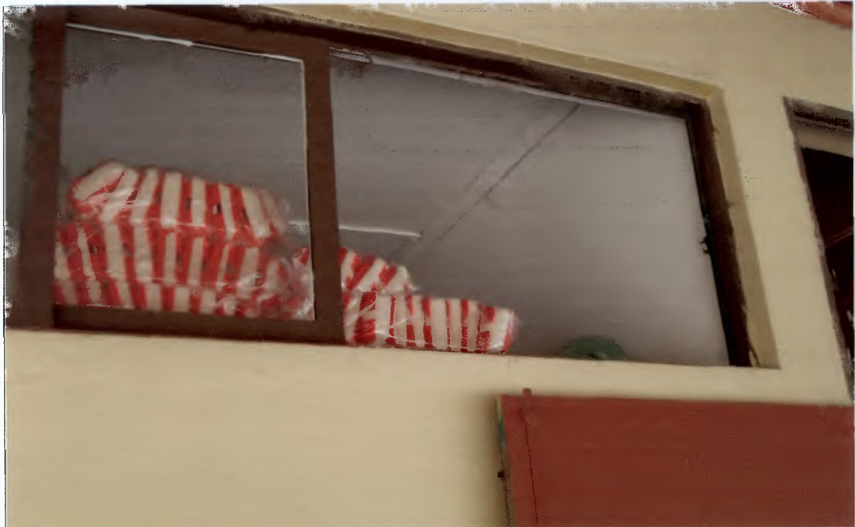
Ventana que permite el acceso de moscas a bodega de alimentos
