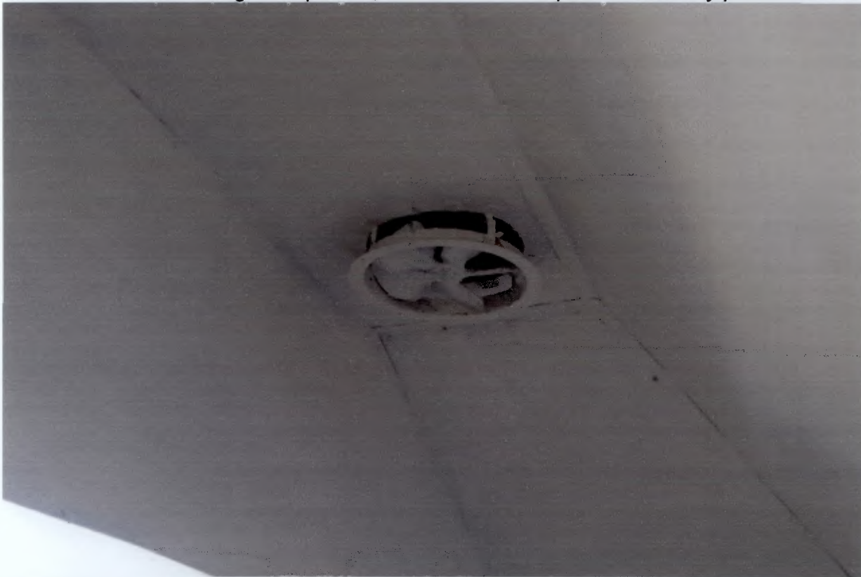
Interior de una campana de cocina sin fuente de poder eléctrica
