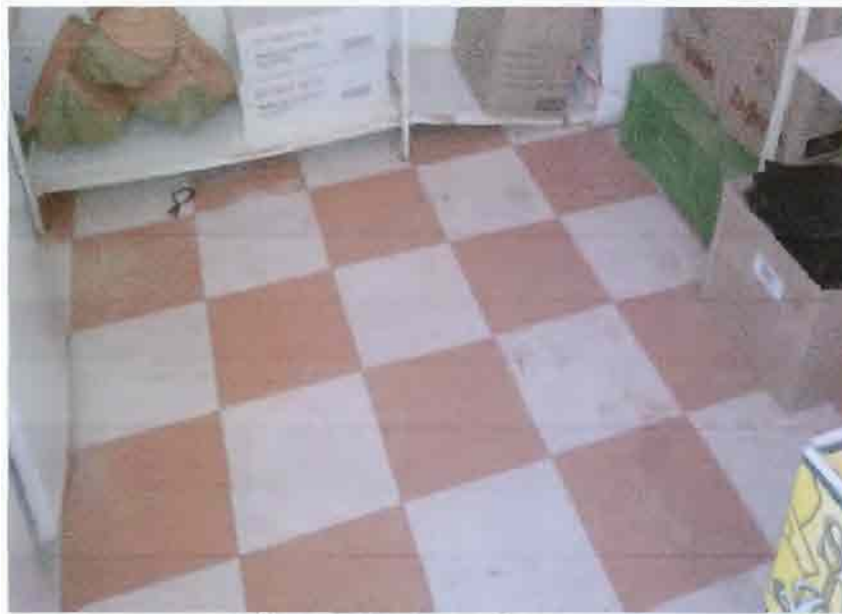
Piso de bodega sin aseo.
