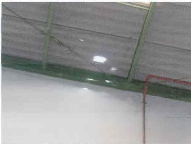
Agujeros en techo de bodega Sodexo S.A.
