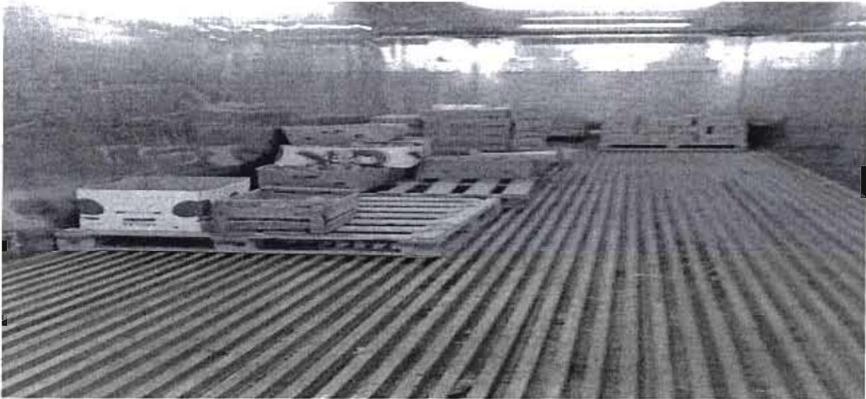
8 Cámara de frío desordenada, sucia y con alimentos como frutas, verduras, yogurts y carnes.
